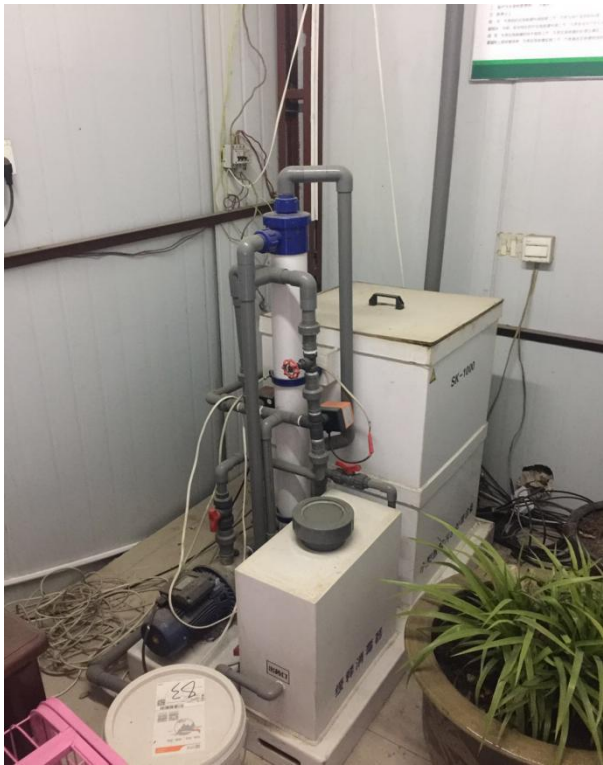
医院废水处理设施
