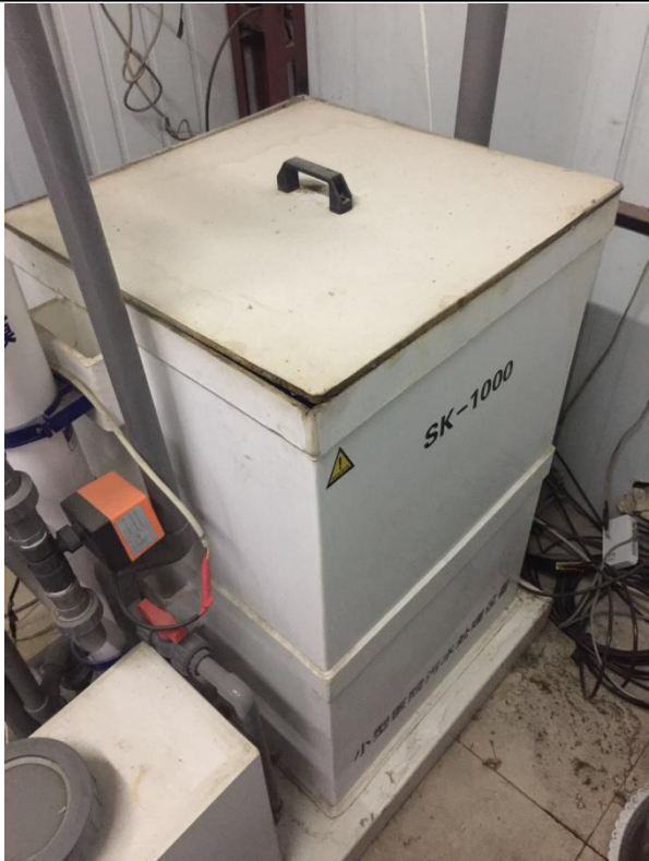
医院废水处理设施
